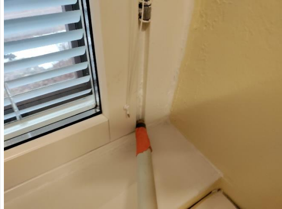
Kuva 7. Ilmavuotokohta ikkunan karmista/liitoskohdasta.
