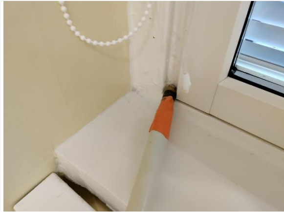
Kuva 3. Ilmavuotokohta ikkunan karmista/liitoskohdasta.
