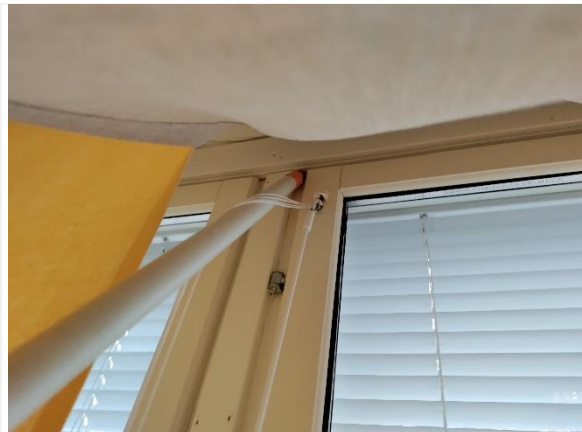
Kuva 9. Ilmavuotokohta ikkunan karmista/liitoskohdasta.
