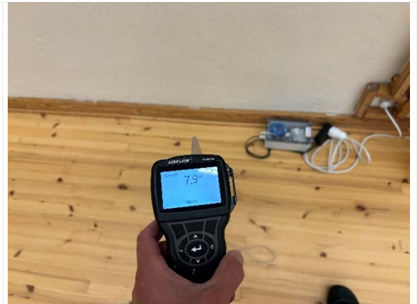
Kuva 7. Hetkellinen paine-ero liikuntasalista ja lattian eristetilan välillä.
