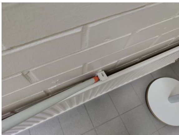
Kuva 14. Patterin kannakkeista havaittiin ilmapuotoa.
