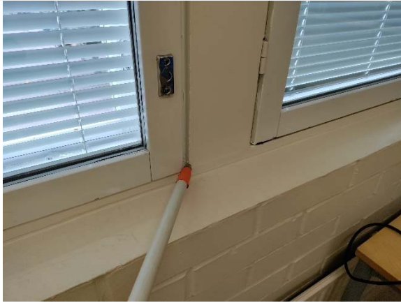
Kuva 43. Ikkunan liitoskohdasta havaittiin il- mavuotoa.
