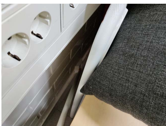
Kuva 18. Alapohjarakenteesta havaittiin voimakasta ilmapuotoa pistorasian kautta.
