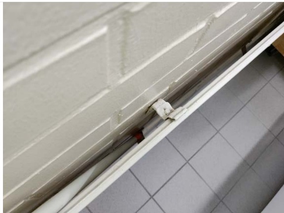
Kuva 21. Patterin kannakkeista havaittiin ilmapuotoa.
