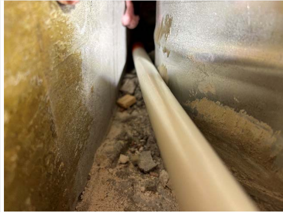
Kuva 94. Ilmavuotopaikka IV-pystyhormin sisällä.
