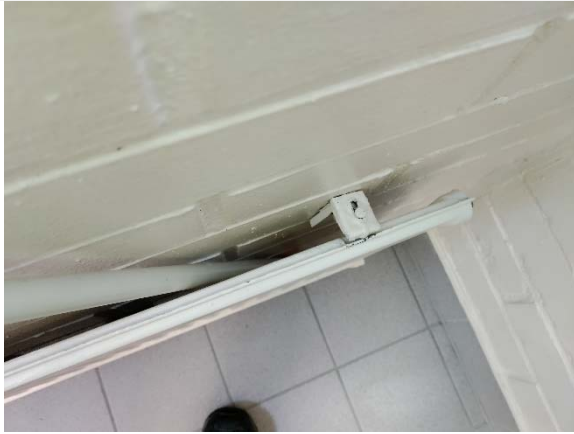
Kuva 9. Patterin kannakkeista havaittiin ilmapuotoa.
