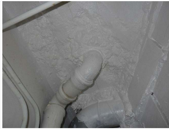
Kuva 96. Käytävän 304 sähkökaapista ei havaittu ilmayhteyttä ullakolle.
