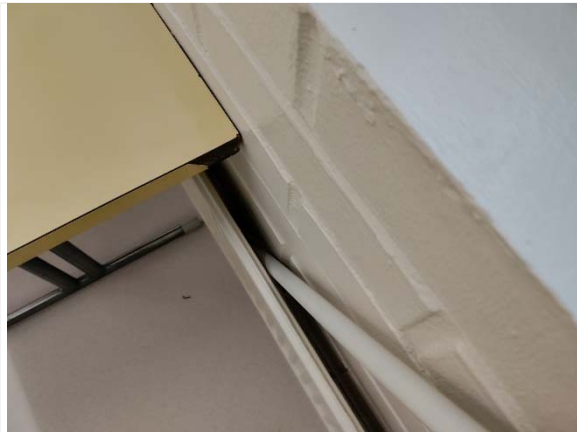
Kuva 38. Patterin kannakkeesta havaittiin ilmavuotoa.
