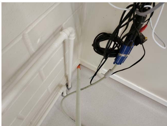
Kuva 28. Muovimaton ylösnostosta havaittiin il- mavuotoa nurkassa.
