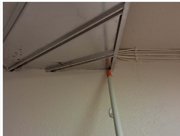
Kuva 72. Vuotopaikka käytävällä sähköhyllyn läpiviennistä.
