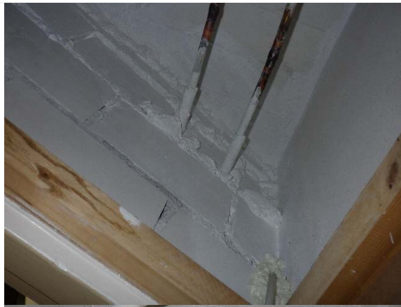
Kuva 95. Käytävän 304 sähkökaapista ei havaittu ilmayhteyttä ullakolle.
