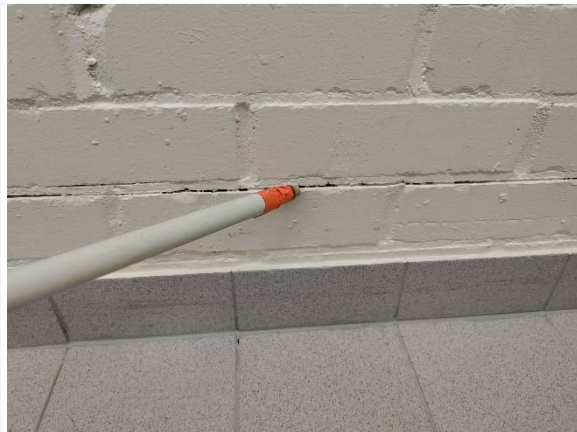
Kuva 22. Alapohjarakenteesta havaittiin voimakasta ilmapuotoa väliseinärakenteen halkeaman kautta.
