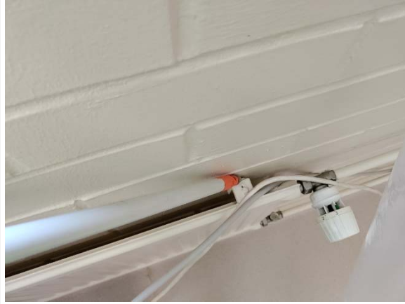
Kuva 32. Patterin kannakkeista havaittiin ilma-vuotoa.
