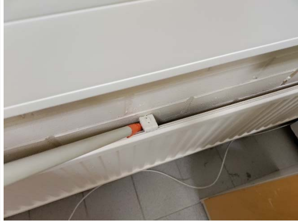
Kuva 2. Yksittäisestä patterin kannakkeesta havaittiin il-mavuotoa.
