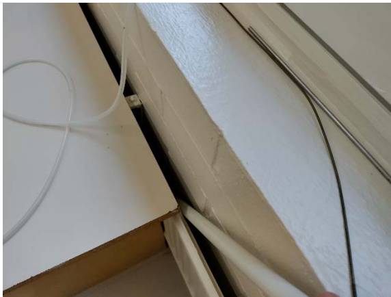
Kuva 57. Patterin kannakkeesta havaittiin ilma- vuotoa.
