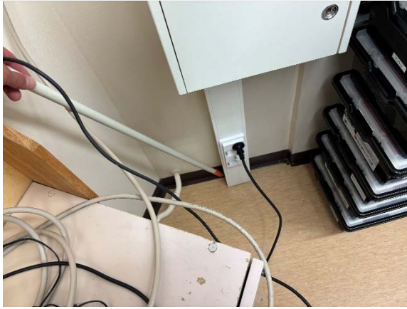
Kuva 89. Ilmavuotopaikka audiokaapin alla seinä/lattia liitoksesta.
