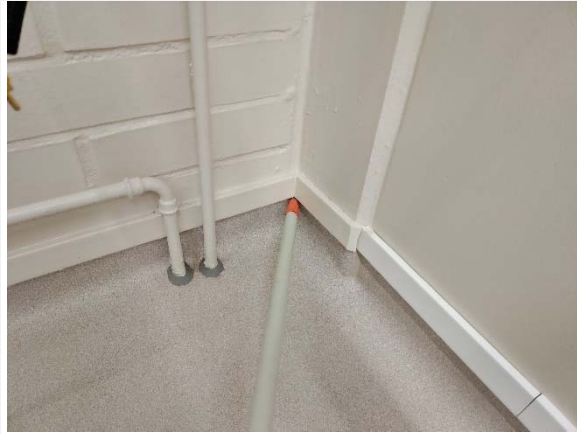
Kuva 44. Muovimaton ylösnostosta nurkassa havaittiin ilmavuotoa.
