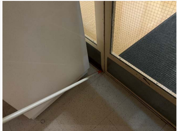
Kuva 68. Vuotopaikka alapohjan kautta palo-oven juuresta.
