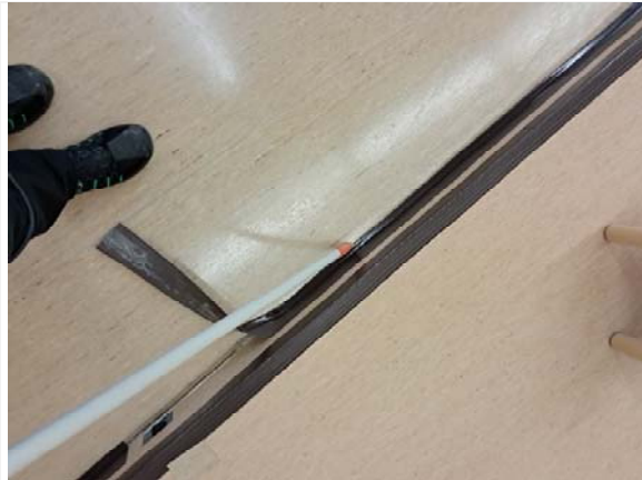
Kuva 92. Korokkeen keskellä havaittiin yksittäinen ilmavuotopaikka.
