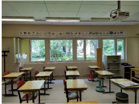
Kuva 36. Tilassa 257 ei havaittu ilmavuotoja ulkoseinärakenteesta.
