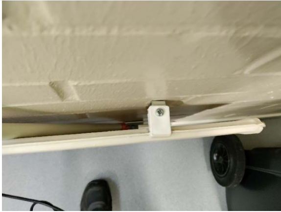
Kuva 51. Patterin kannakkeesta havaittiin il- mavuotoa.
