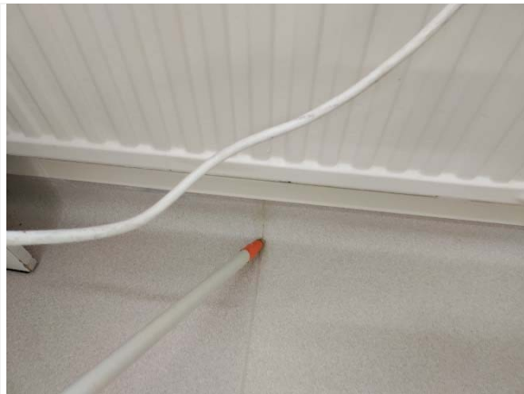
Kuva 34. Muovimaton saumasta havaittiin ilma-vuotoa.
