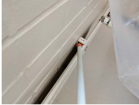
Kuva 24. Patterin kannakkeista havaittiin ilma-vuotoa.
