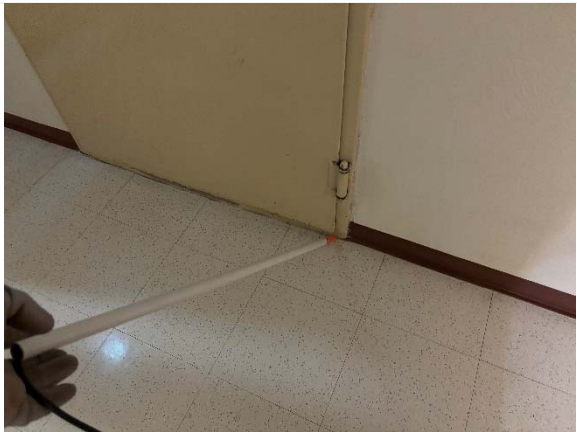
Kuva 67. Vuotopaikka alapohjan kautta lämmönjakuhuoneen oven juuresta.
