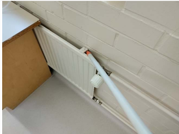
Kuva 56. Patterin kannakkeesta havaittiin ilma- vuotoa.
