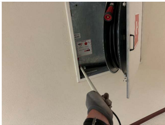
Kuva 71. Vuotopaikka käytävän palopostin kautta.
