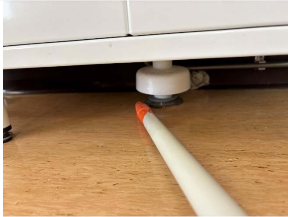
Kuva 93. Ilmavuotopaikka korokkeen viemärin läpiviennistä.
