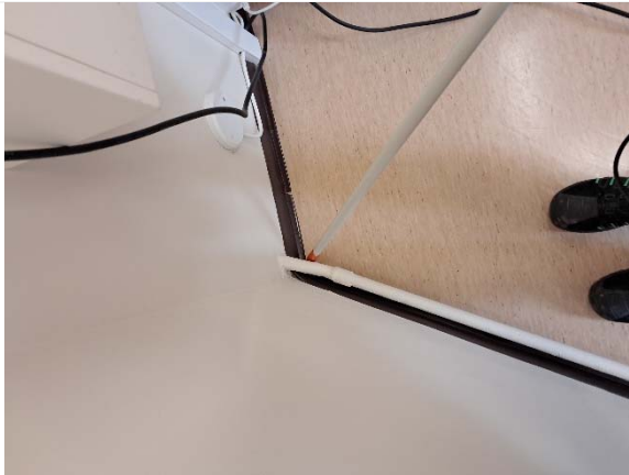
Kuva 91. Ilmavuotopaikka opettajan korokkeen ja ulkoseinän liitoskohdassa.
