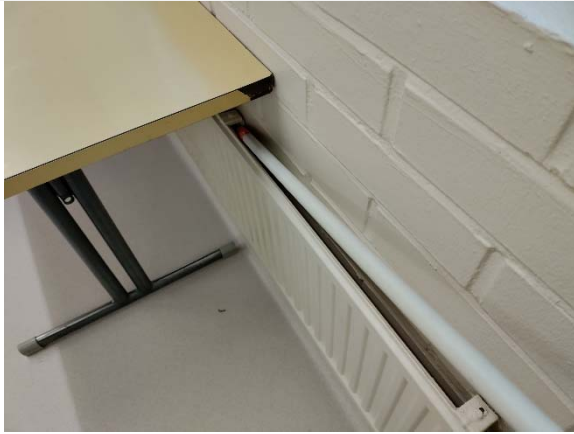
Kuva 39. Patterin kannakkeesta havaittiin ilma- vuotoa.
