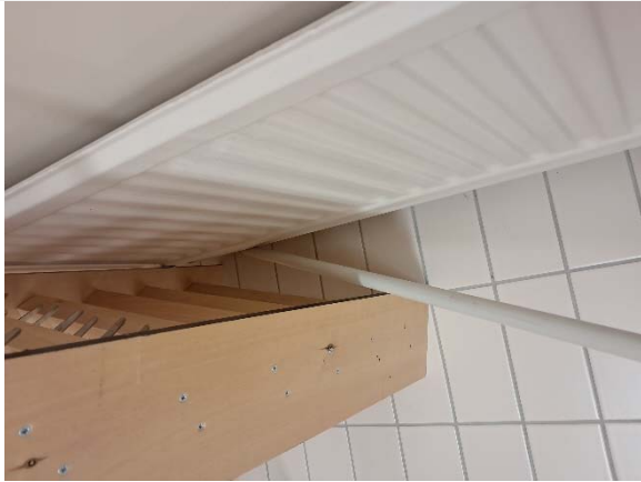
Kuva 65. Vuotopaikka lattian/seinän liittymästä.
