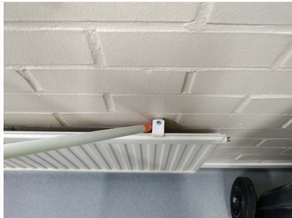
Kuva 50. Patterin kannakkeesta havaittiin ilmavuotoa.
