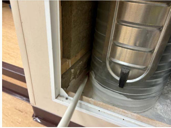
Kuva 90. Ilmavuotopaikka IV-pystyhormin sisältä.
