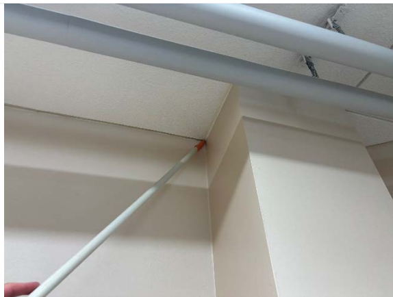
Kuva 87. Ilmavuotopaikka kotelon yläreunasta.
