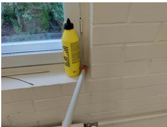
Kuva 59. Ikkunapenkin nurkasta havaittiin ilma- vuotoa.
