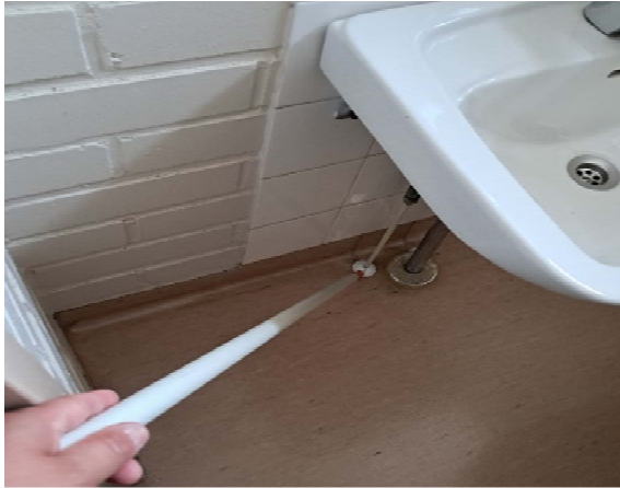
Kuva 75. Vuotopaikka vesiputken läpiviennistä.
