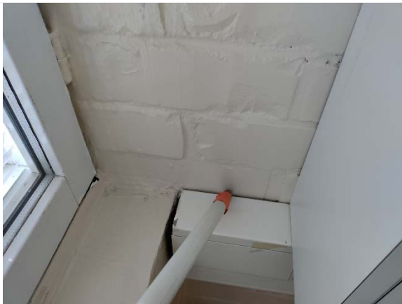
Kuva 11. Sähkökourun takaa väliseinärakenteessa havaittiin ilmapuotoa.
