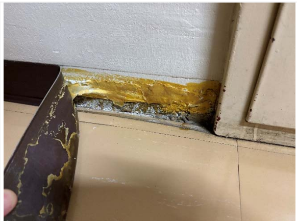
Kuva 78. Lattian seinän liittymästä puuttuu tiivistys.
