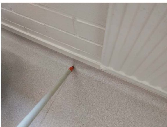
Kuva 30. Muovimaton saumasta havaittiin ilma- vuotoa.
