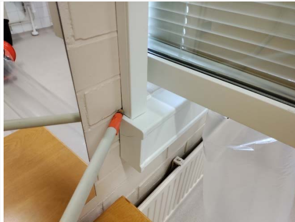
Kuva 48. Sähkökourun takaa havaittiin ilmavuotoa.
