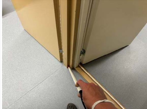
Kuva 86. Ilmavuotokohta ovenkarmien juuresta.
