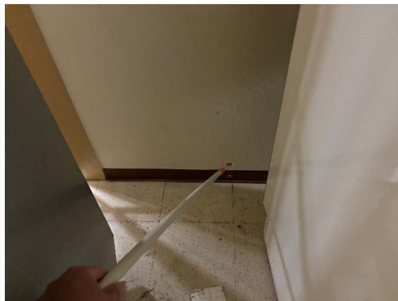
Kuva 64. Ilmavuotopaikka seinässä olevasta reiästä käytävän puolella.
