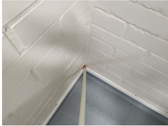
Kuva 52. Muovimaton ylösnostosta nurkassa havaittiin ilmavuotoa.
