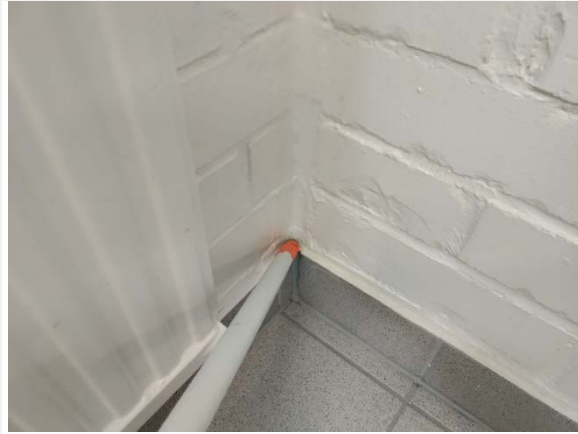
Kuva 10. Ulkoseinän ja väliseinän alanurkassa havaittiin vähäistä puotoa.
