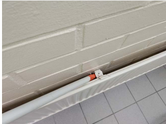
Kuva 20. Patterin kannakkeista havaittiin ilmapuotoa.
