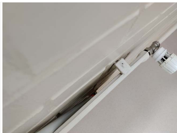
Kuva 27. Patterin kannakkeista havaittiin ilma- vuotoa.
