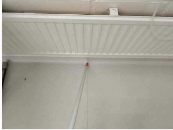
Kuva 40. Muovimaton saumoista havaittiin il- mavuotoa.
