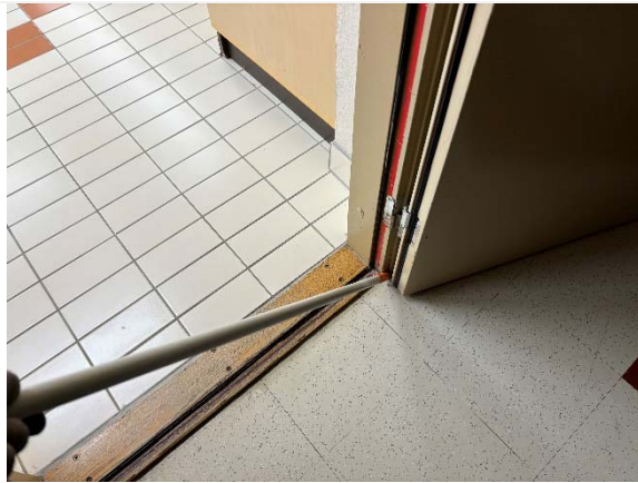
Kuva 69. Vuotopaikka alapohjan kautta luokan oven juuresta.
