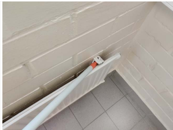
Kuva 8. Patterin kannakkeista havaittiin ilma- vuotoa.
