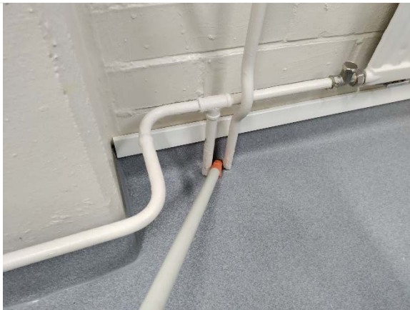
Kuva 53. Patteriputkien läpiviennistä havaittiin ilmavuotoa.
