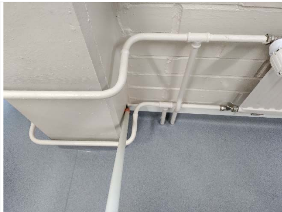
Kuva 54. Muovimaton ylösnostosta pilarin nur- kassa havaittiin ilmavuotoa.
