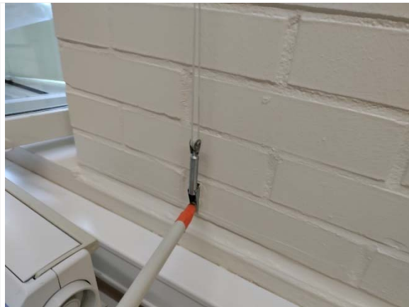
Kuva 58. Verhon kiinnikkeestä havaittiin ilma- vuotoa.
