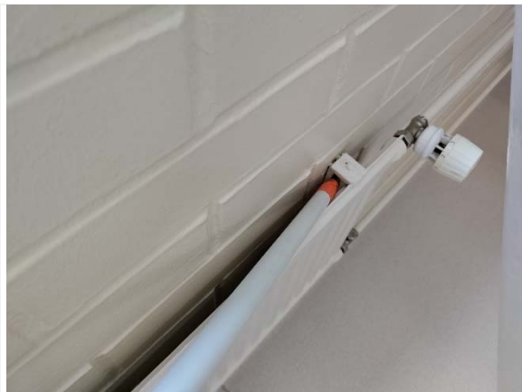
Kuva 26. Patterin kannakkeista havaittiin ilma-vuotoa.
