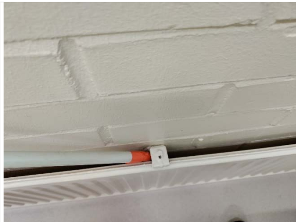
Kuva 42. Patterin kannakkeesta havaittiin ilma- vuotoa.
