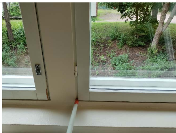
Kuva 60. Ikkunanliitoksesta havaittiin ilmavuo- toa.
