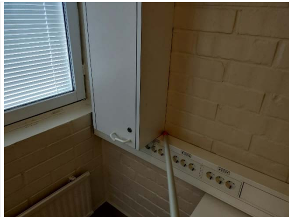
Kuva 12. Kaapin takaa väliseinärakenteessa havaittiin ilmapuotoa.
