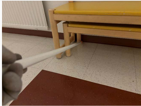
Kuva 70. Vuotopaikka alapohjan kautta seinän/lattian juuresta.
