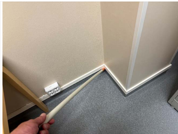
Kuva 88. Ilmavuotopaikka kotelon alareunasta.
