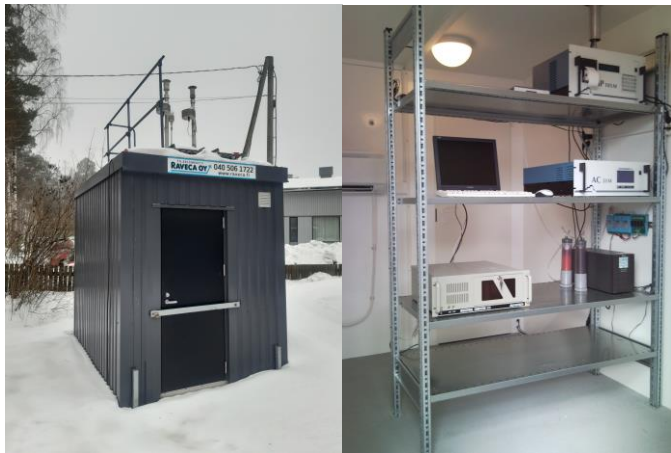
Kuva 2. Mittauskoppi ulko- ja sisäpuolelta.
