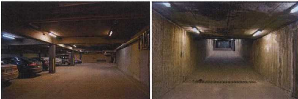
Kuva 5-8 Autohallin käyttöaste on kohtalainen. Ajoluiskassa näkyy kosteusvaurioita.
